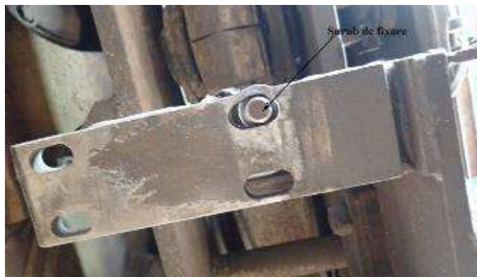
Foto nr.4 Suport orizontal fixare inductor (partea din spate) post I
