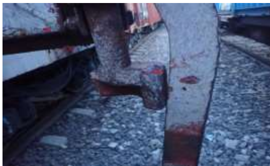
Foto nr.5 Urme lovire camă de fixare
