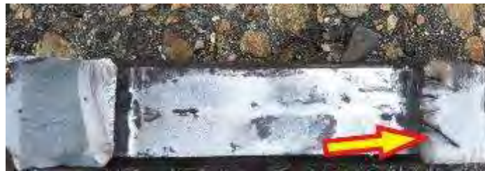
Imaginea 10 – fisură veche în secțiunea de rupere a bridei pendulare
