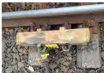
Imaginea 2 – Inductor de cale avariat
