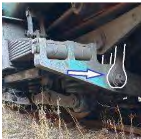
Imaginea 6 – Bridă pendulară, montată în poziție normală de funcționare (exemplu)
