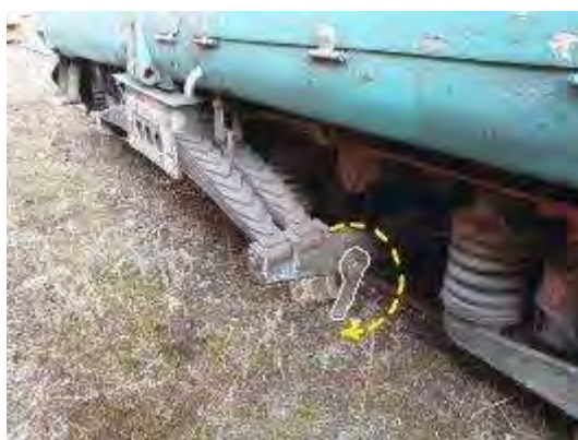
Imaginea 11 –Brațele rupte ale bridei pendulare, s-au rotit înspre inductorii din cale (exemplu)
