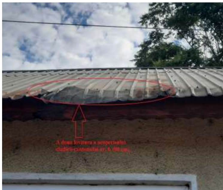
Foto nr.3 – a doua lovitură a acoperișului clădirii cantonului nr.6,
