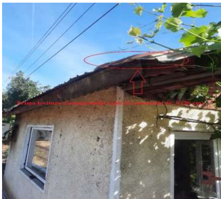
Foto nr.2 – prima lovitură a acoperișului clădirii cantonului nr.6, pe o lungime de 20cm
