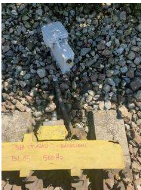
Imaginea 2 – Inductor de cale avariat
