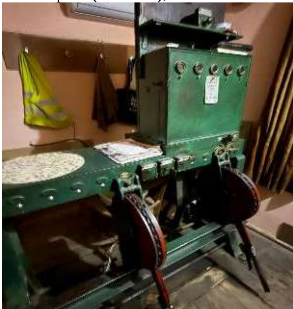
(Foto nr.1) Aparatul de manevră cabina nr.1
