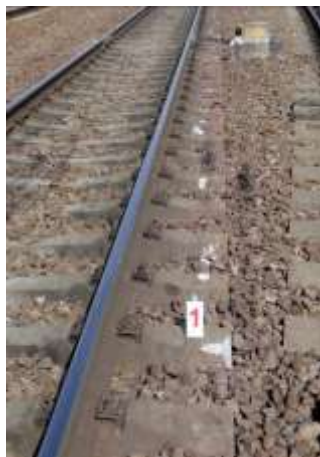
Foto nr.1 Urmările incidentului în stația CFR Cernavodă Pod
