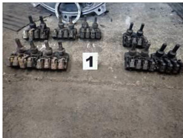
Foto nr.11 – suportii port-perii afectați ai MT nr.1
