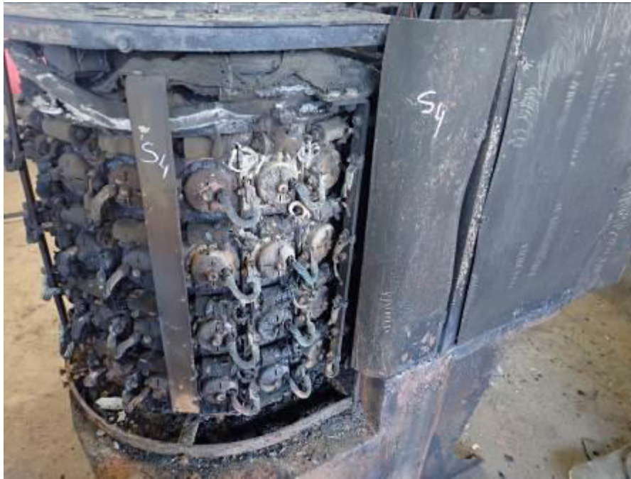
Foto nr.12 – blocul de aparate S4
